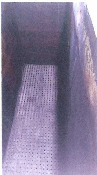
Figure 6 : Vue à l'intérieur d'un bassin Biopur© C vide lors des travaux d'assainissement entrepris au printemps 2023.
